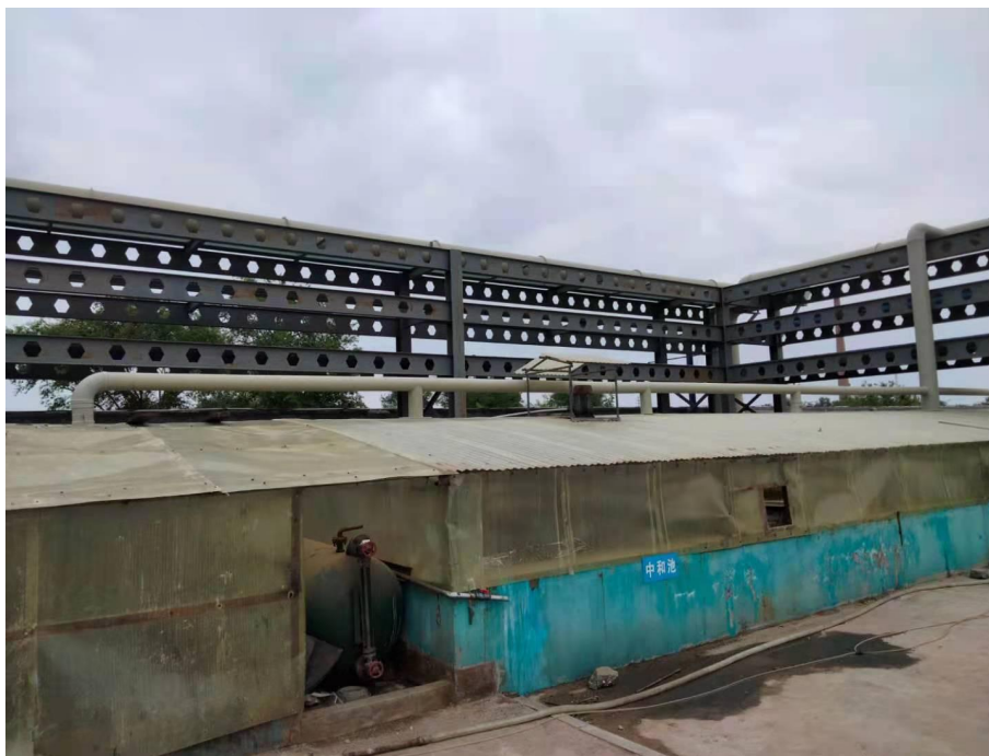
厂区污水处理站
