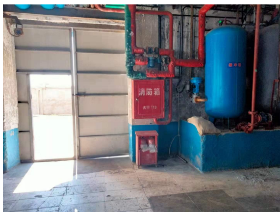
车间消防设施
