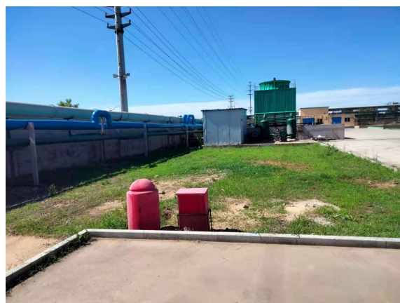
厂区消防设施
